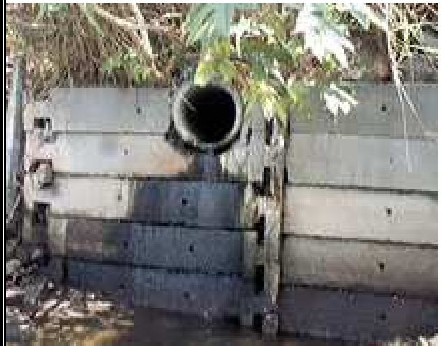
Foto 6- Esgoto in natura na Laguna de Itaipú
