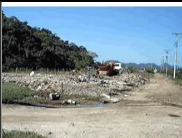
Foto 4 – Base do Morro da Peça, com aterro e arruamento na beira da Laguna
